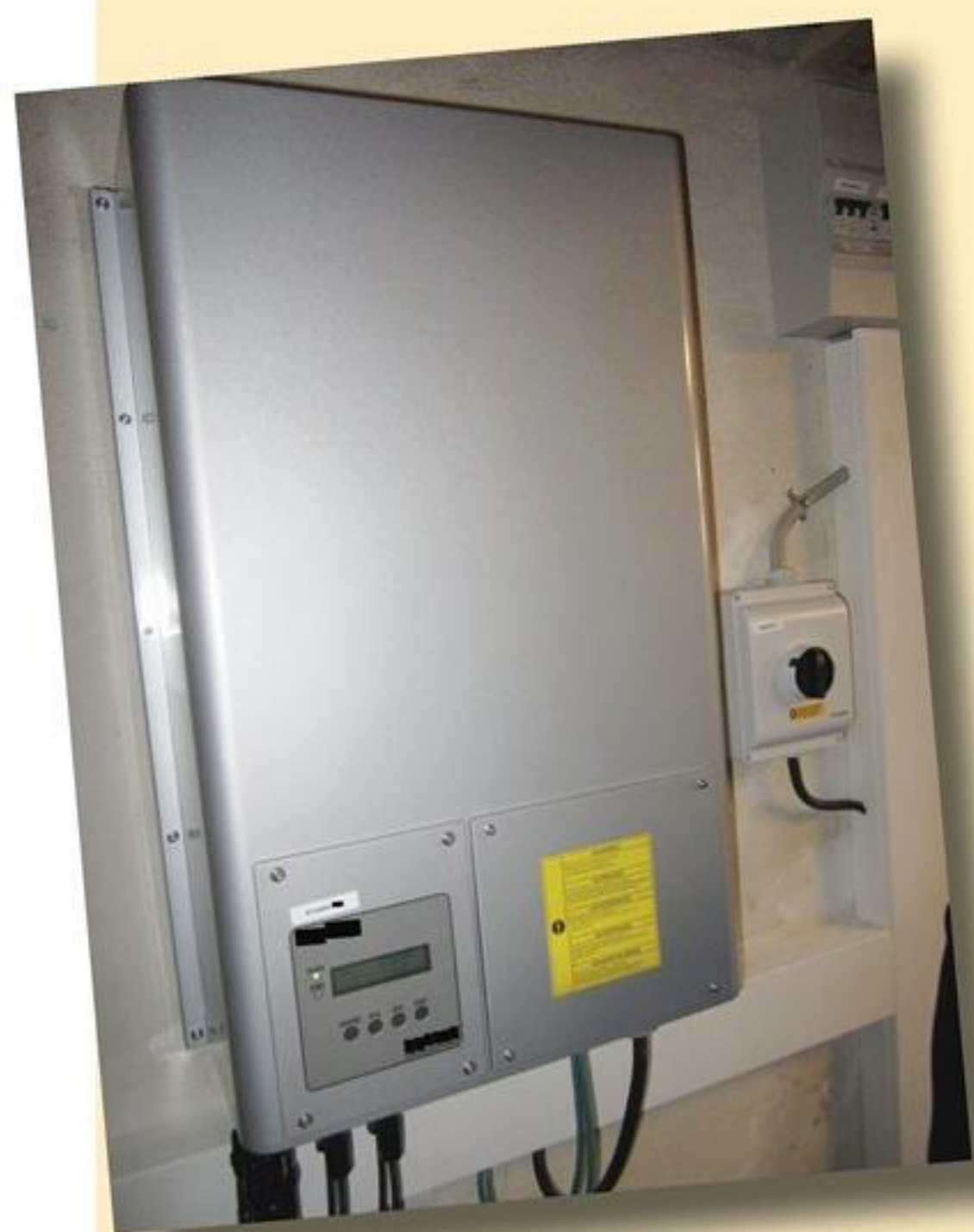
Fig. 22. 10 kW inverter uden DC-afbryder. Ikke et krav, men må stærkt anbefales.
