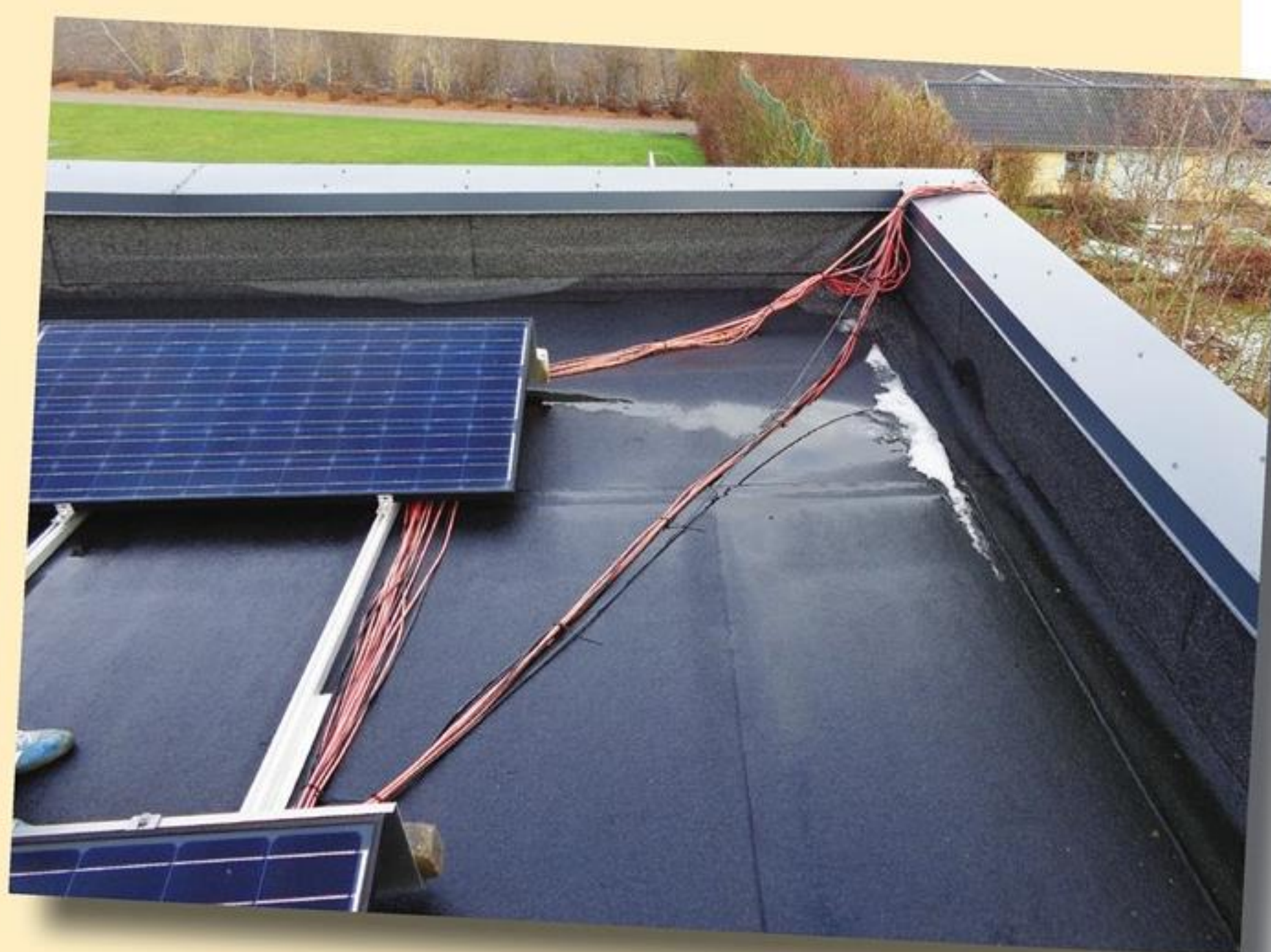
Fig. 13. Kabler ligger løst og udsat.
