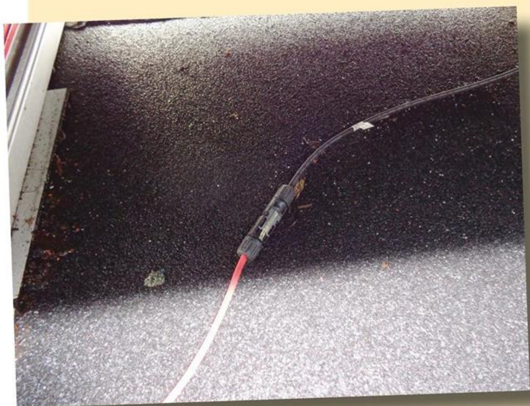
Fig. 14. Kabelsamling hvor der kan stå fugt.
