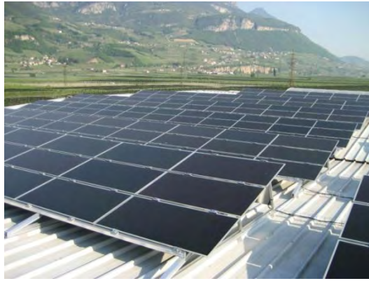
Figur 2 - Solceller på skråstillede stativer
